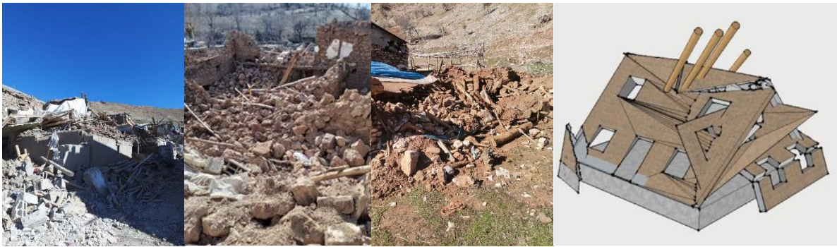
Şekil 6. Tamamen göçmüş yığma yapı örnekleri
