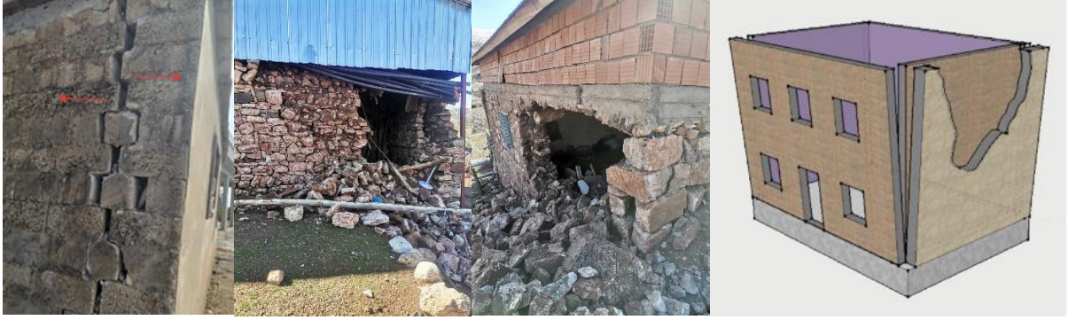
Şekil 10. Taşıyıcı duvar köşe noktalarında meydana gelen hasarlar
