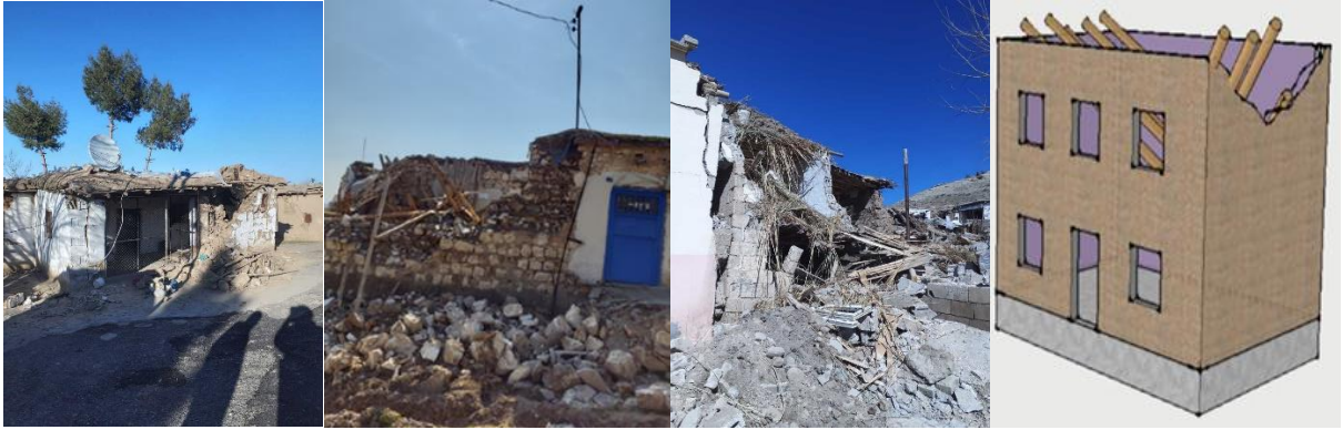
Şekil 8. Göçme mekanizmasına ulaşan ağır toprak damlarından dolayı oluşan taşıyıcı duvar hasarları
