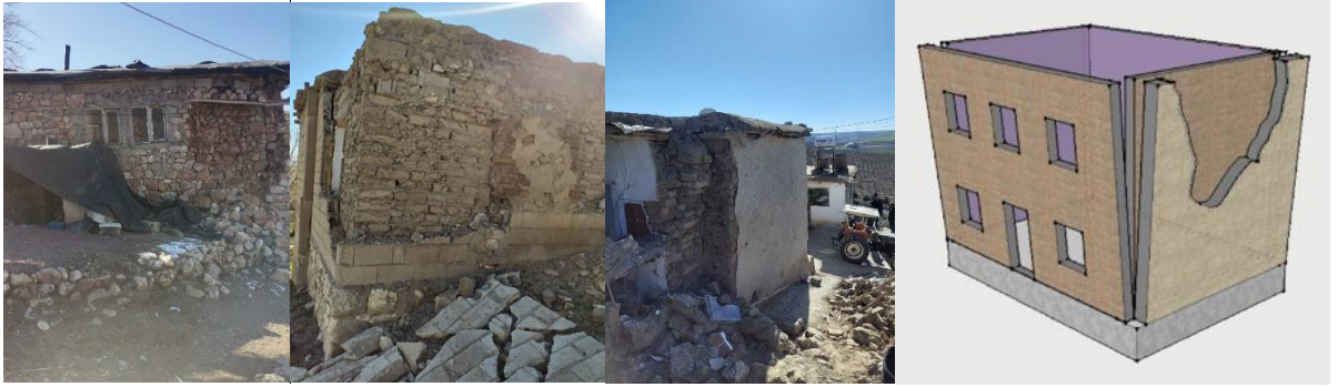
Şekil 11. Farklı veya aynı malzeme türleri arası yeterli kenetlenme olmaması sonucu oluşan ayrılma hasarları
