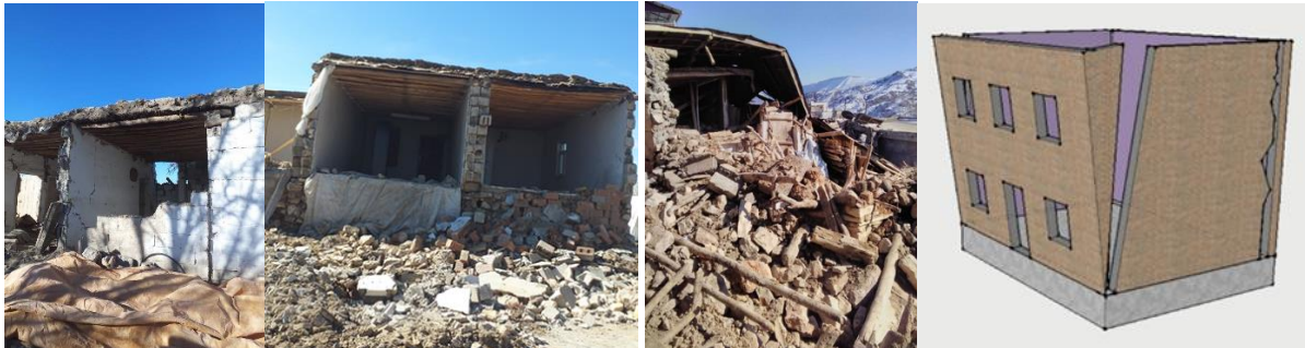
Şekil 9. Yığma yapılarda gözlemlenen düzlem dışı taşıyıcı duvar hasarları
